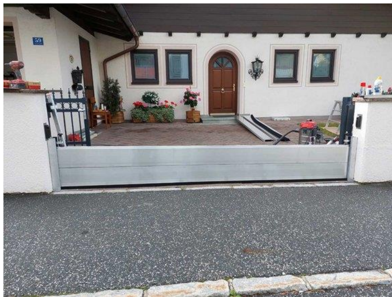
Abb. 60: Hochwassershott an Hofzufahrt (Quelle: imt hochwasserschutz)
