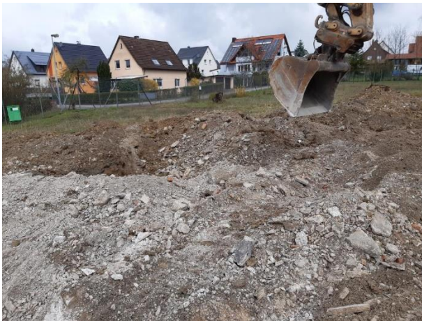
Abbildung 18 Auch an eigentlich harmlosen Stellen finden sich Schadstoffe, hier Bauschutt mit Asbestzementbruch
