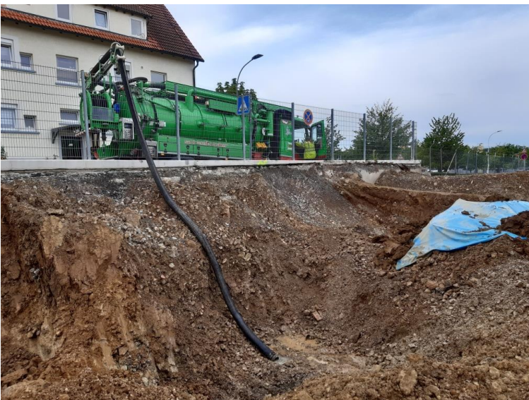
Abbildung 6 Abpumpen von mineralölverunreinigtem Schichtwasser mit aufschwimmender Ölphase
