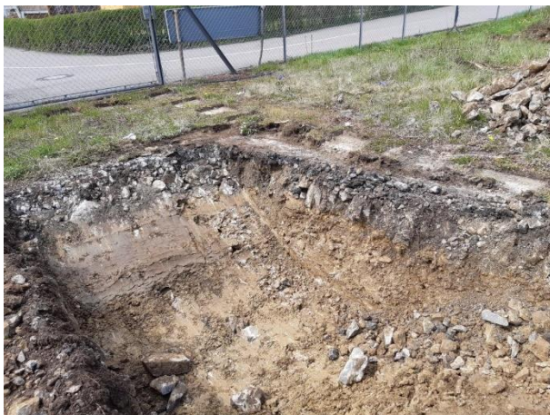
Abbildung 19 Werkszufahrt im Osten, die PAK-Kontaminationen zogen sich bis in Tiefen von ca. 1 m
