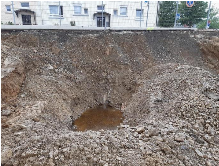
Abbildung 5 Mineralölverunreinigtes Bodenmaterial / Schichtwasser mit aufschwimmender Ölphase,
