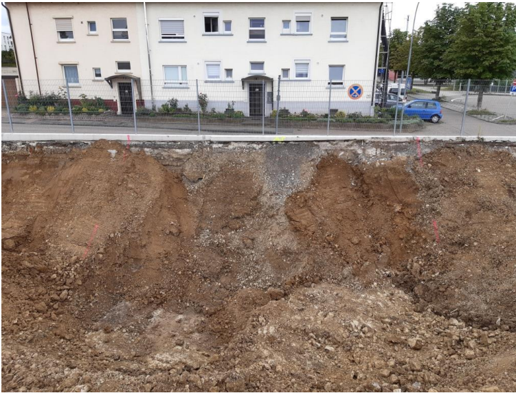
Abbildung 9 Vermutete Ausdehnung der Kontaminationen entlang/ unterhalb des Werkszaunes (rosa Markierungen links und rechts)
