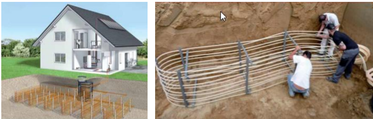
Abbildung 62: Erdkollektoren (Roth Werke GmbH, 2019)
