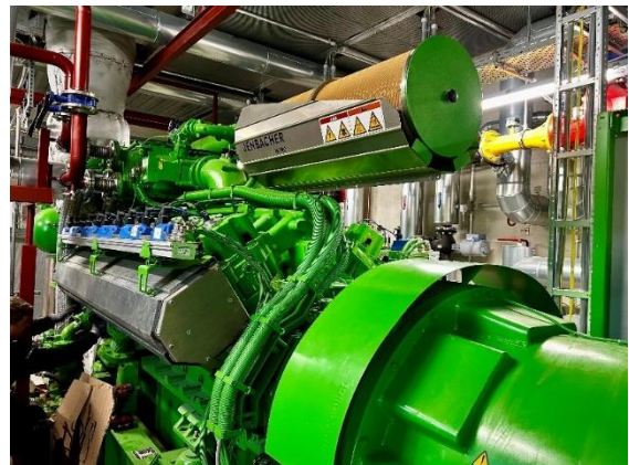
Biogas-Blockheizkraftwerke Firma Frener 2 x ca. 2.000 kW th
