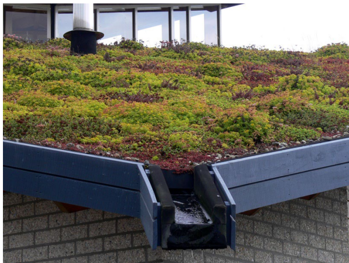
Abbildung 1: Ein extensiv begrüntes Dach. Quelle: Lamiot https://commons.wikimedia.org/wiki/File:EVA-_Lanxmeer_Green_roof2_2009.jpg , https://creativecommons.org/licenses/by-sa/4.0/legalcode
