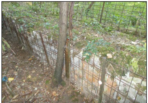
Abb.12: ausgetrockneter Kanal mit Stahlmattenbefestigung und Zaun im Hintergrund
